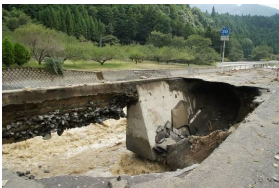
2011(平成 23)年 9 月 台風第 15 号の被害
