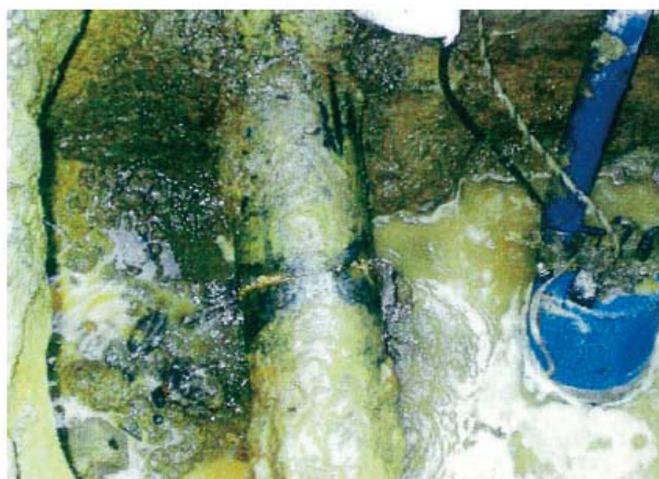
「東日本大震災水道施設被害状況調査最終報告書（平成 25 年 3 月）」第 4 章各地の被災状況 より
