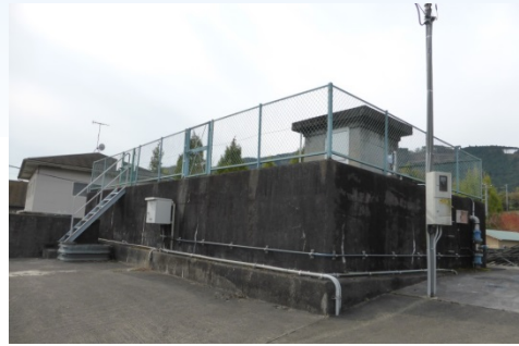
図 3-12 桂林第 1 配水池
