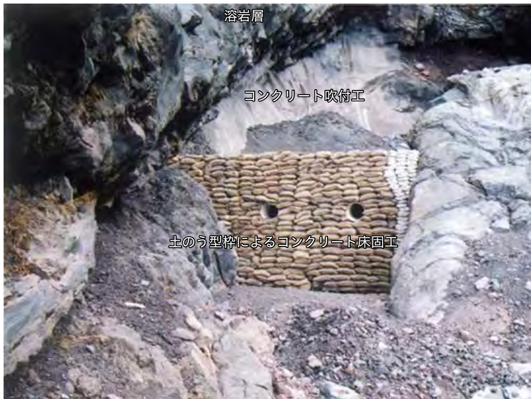
写真 2-4 溶岩層の崩落とスコリア層の侵食を防止する滝保護工
